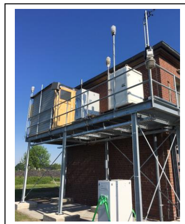
Abbildung 1: Luftmessstation in Wedel an der Elbe ca. 10 km vor dem Hafen Hamburg mit aktivem und passivem DOAS Messsystem, drei in-situ Spurengasmonitoren und Wetterstation, sowie AIS Empfangs- und Datenfernübertragungsanlage. Schiffe passieren die Messstation in einem Abstand von ca. 200-600 m.
